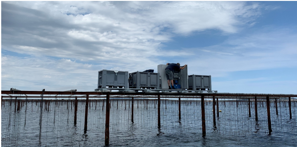
Le système Inergys en phase d'installation
